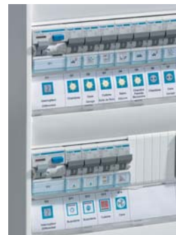
Repérage des circuits dans les coffrets
