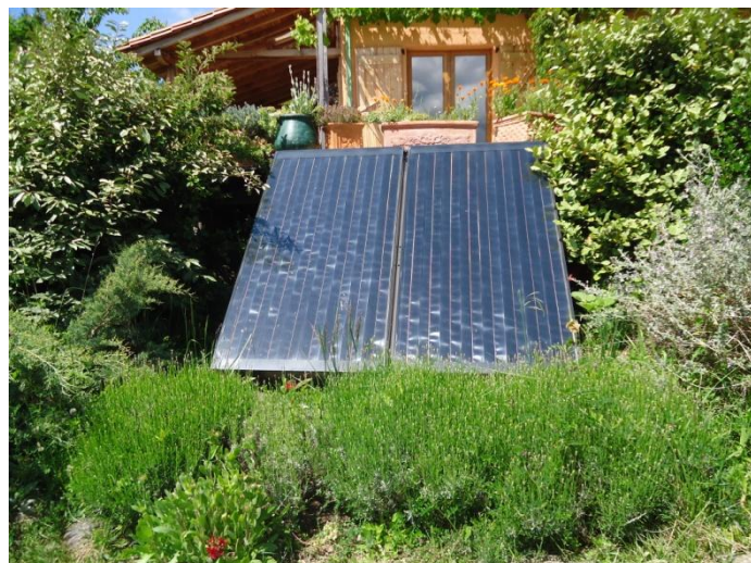
Fig.89: chauffe eau solaire entouré de végétations
